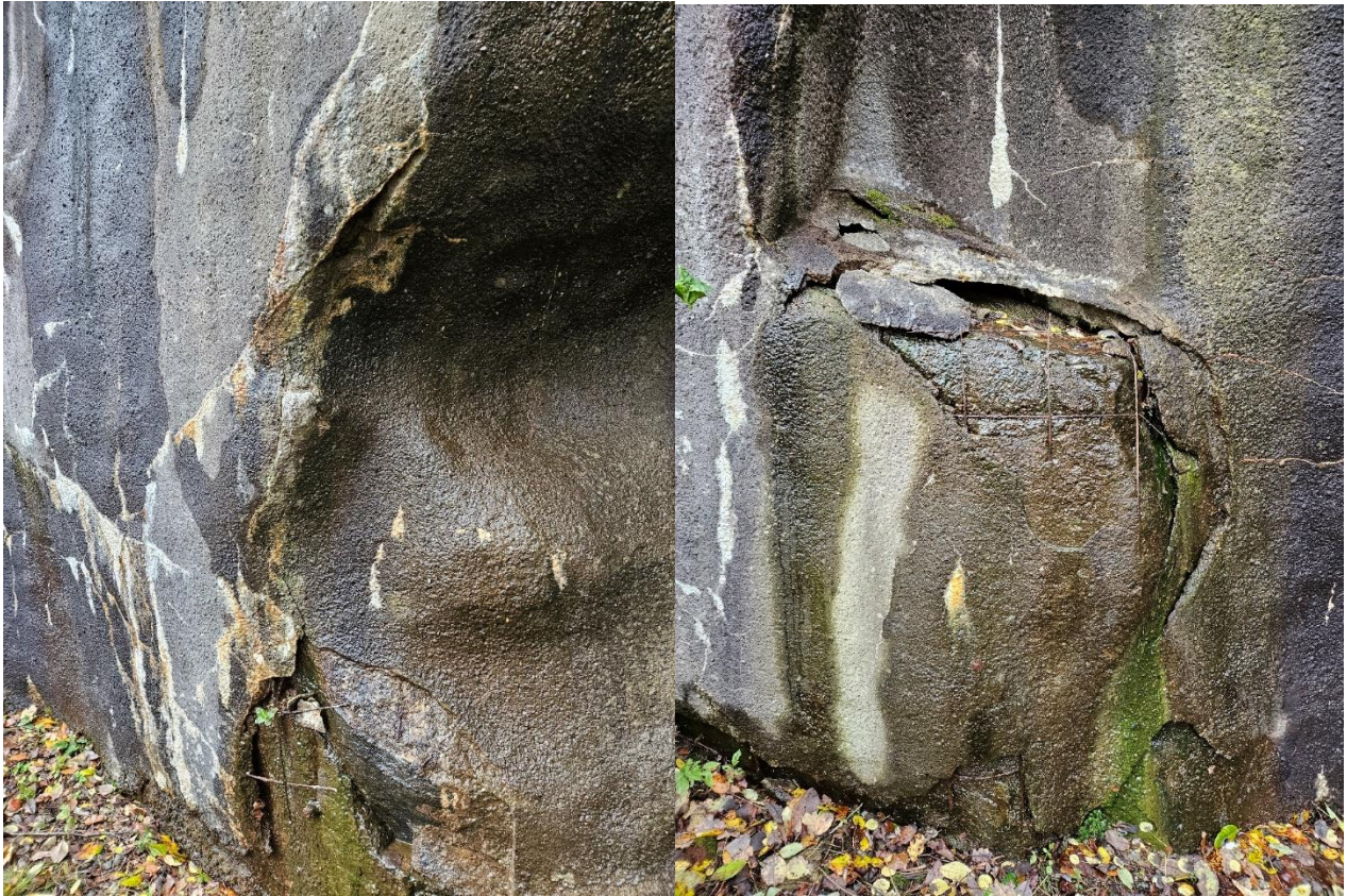
Figur 4 Fotografier av krackelering och släpp i den armerade sprutbetongen i södra delen av den befintliga slänten. Se skada 4 i Figur 7.
