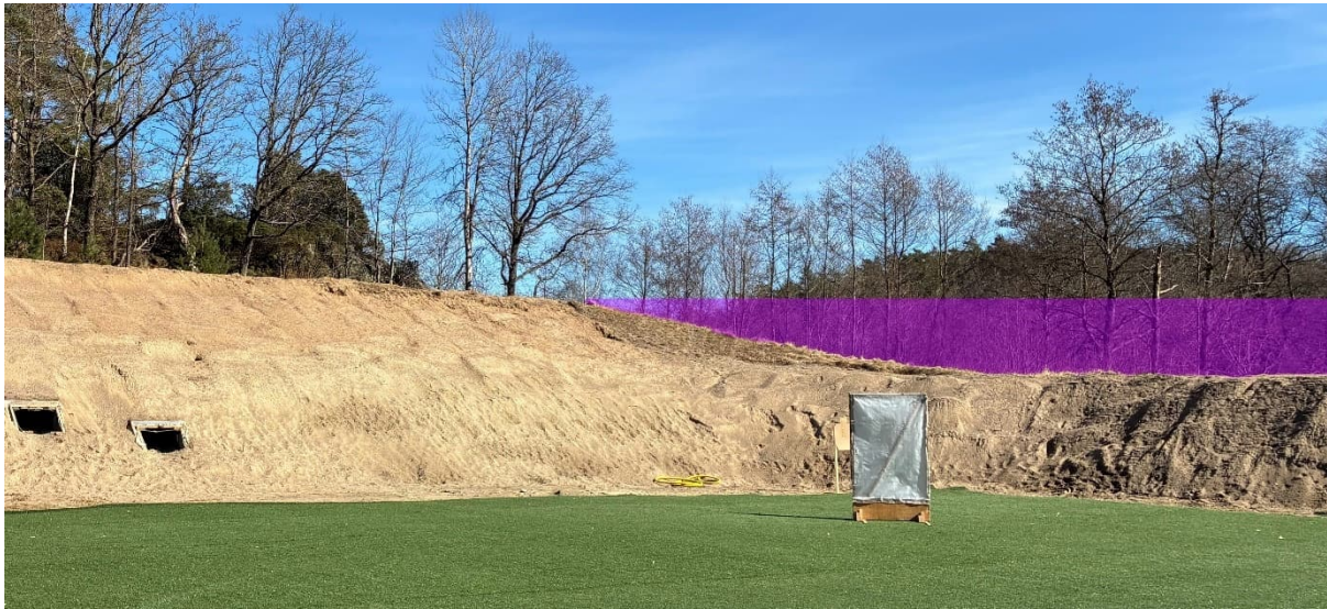
Figur 11. Det lila området markerar föreslagen justering av vällen så att ett ca 50 m långt avsnitt får markhöjd ca 78 m.ö.h.
