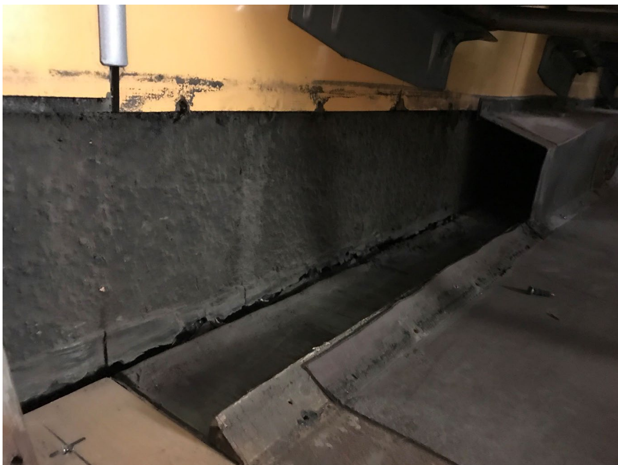
Figur 3 Ventilationskanal under rostfri sparkplåt
