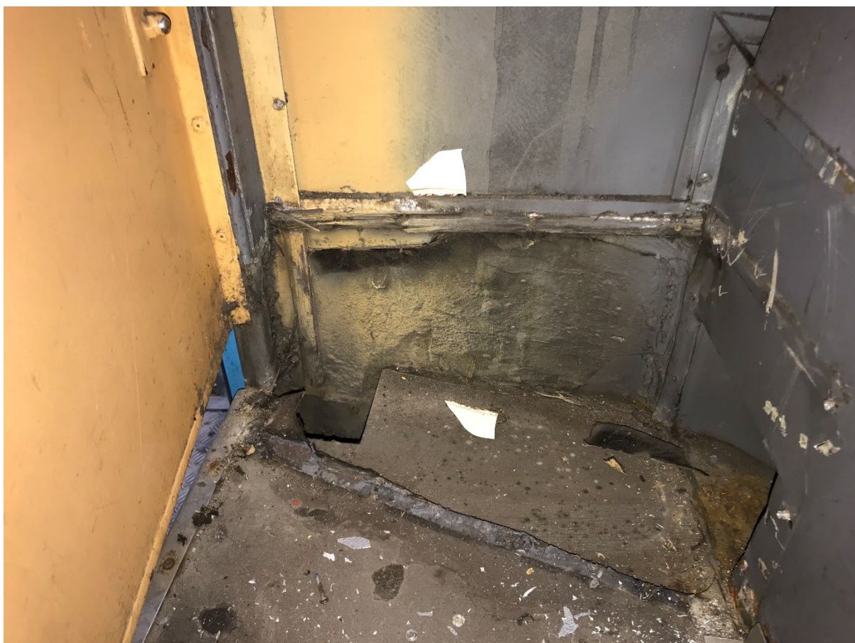
Figur 4 Ventilationskanal under rostfri sparkplåt akter om dörr 5
