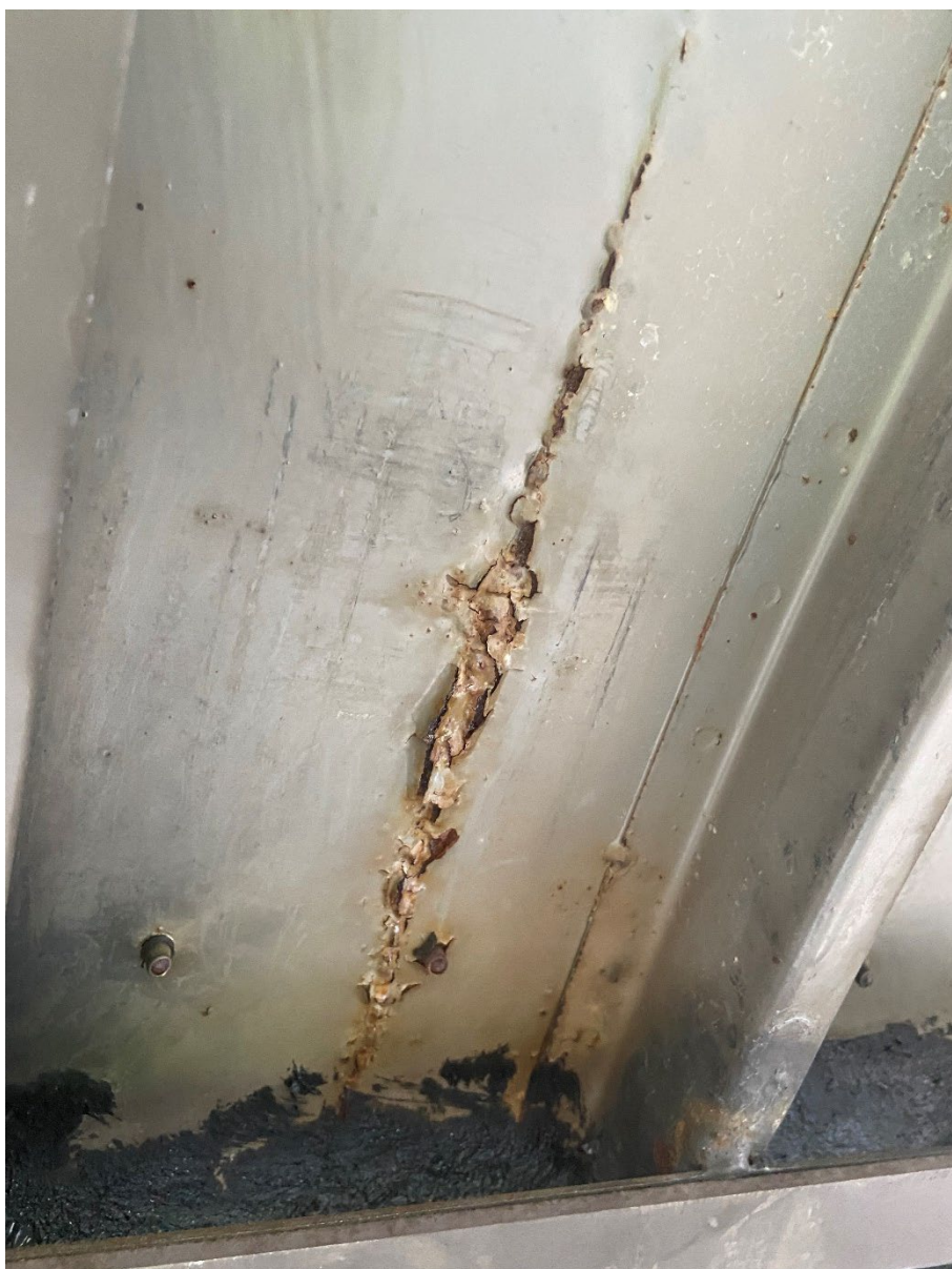
Figur 12 Svart massa på insidan av hängrännor / stödlinor där tak möter vägg
