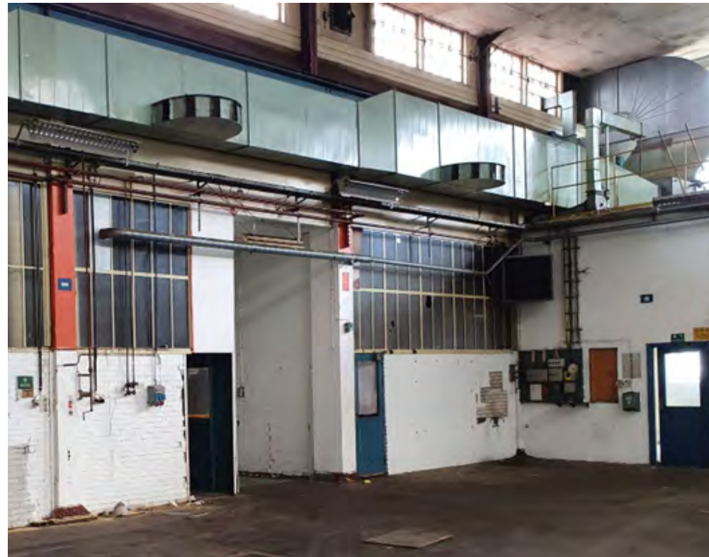
M-verkstaden med rum i rummet, platsbyggda ventilationskanaler som plåtslagarkonst. Bild: Johanna Lange
