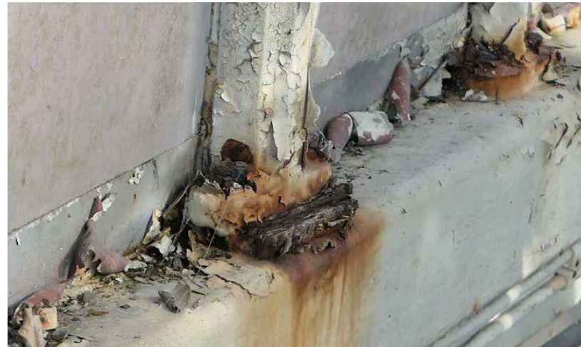
Rostangripen anslutning mellan balk och takkonstruktion.
