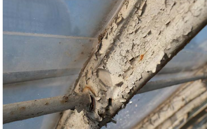
Gjutjärnsspröjs som uppvisar omfattande färgflagnings och rost.
