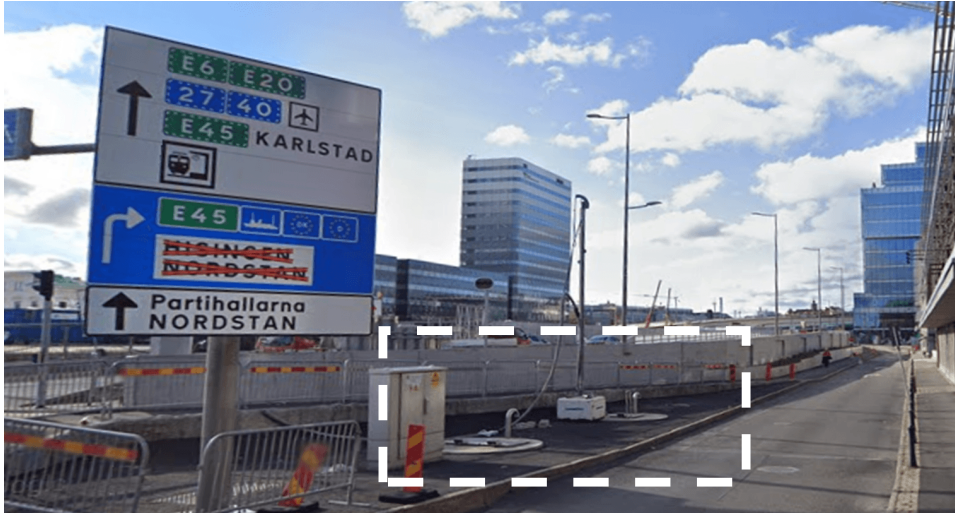
Figur 48: Bild visar befintlig spillvattenpumpstation vid Kilsgatan.
