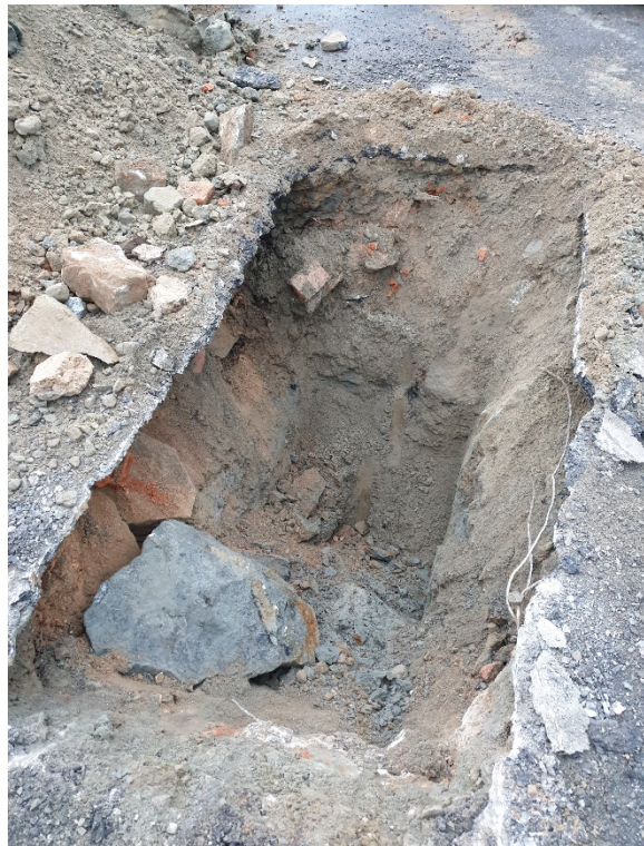
Figur 6. PG1907 som visar fyllnadsmaterial med rivnings rester (tegel, armering) samt sprängsten.
