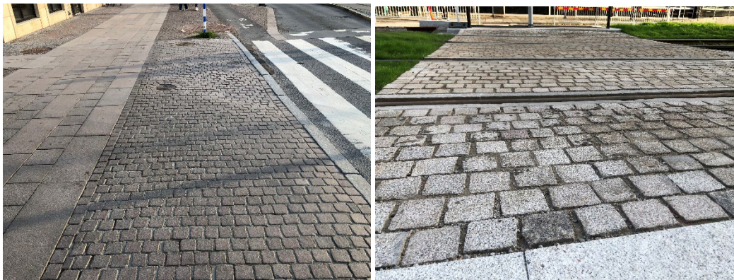
Ojämn knott mellan granithällar och övergångsställe vid Kvarteret Röda Bryggan samt ojämn knott i passage över spårvagnsspår i Första Långgatan.
