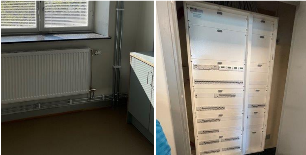
Nya radiatorer på hela skolan och nya el-centraler
