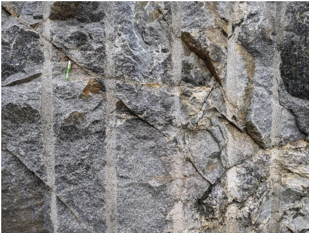
Figur 3.1.2 Sprickytor med beläggningar av järnoxid. Borrpipor från tidigare utförd sprängning syns tydligt.
