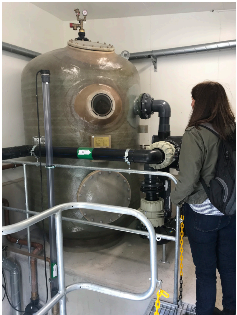
Trycksandfilter i en av Stocholms stads anläggningar
